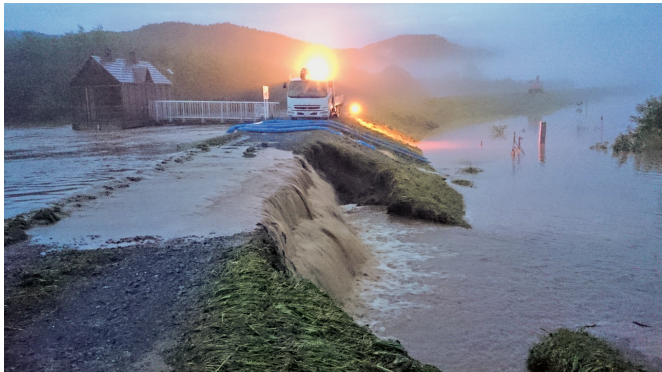
2016(平成28)年 大雨でこわれた堤防(常呂川) ていぼう (出典:北海道開発局)
