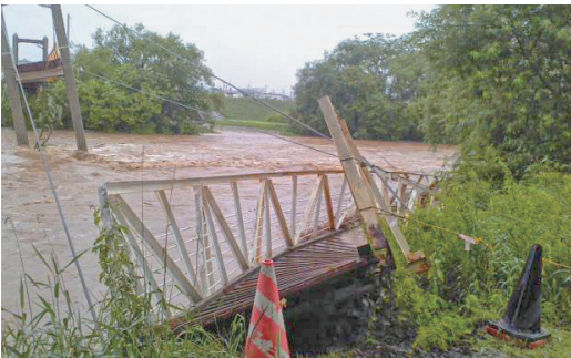
2014(平成26)年 大雨でこわれた橋(無加川) むか
