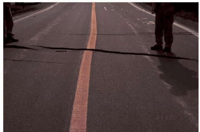
湖岸道路で見られた前兆の地割れ
