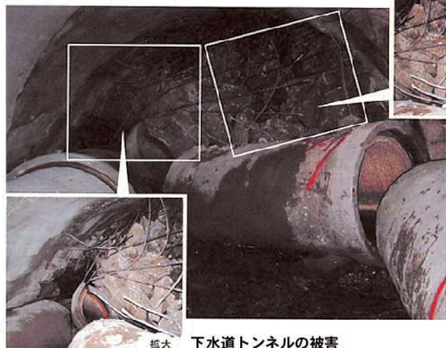
下水道トンネルの被害
