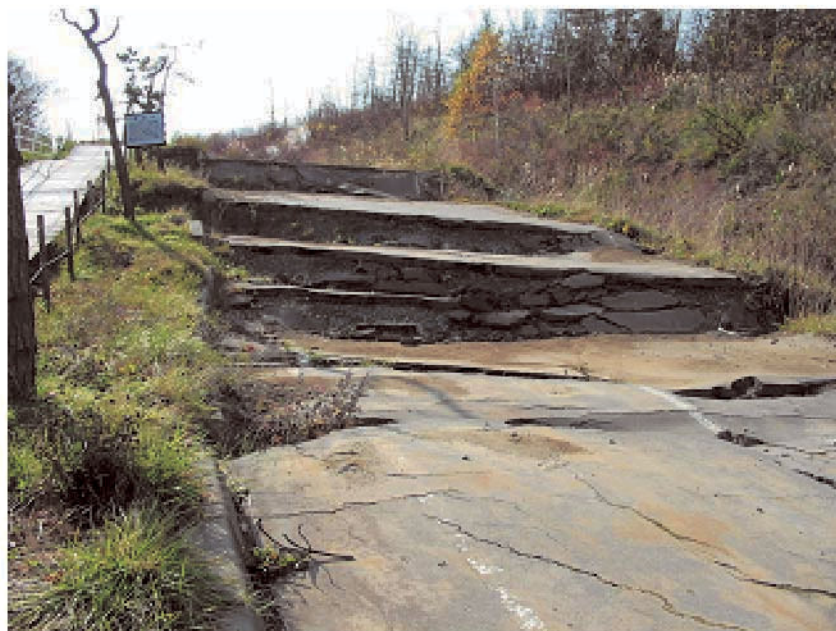
地殻変動によって段差のできた町道
