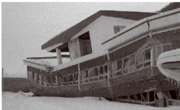
1階は完全に潰れ、2階部分もたわみ始めている。(1978年3月)
