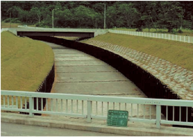
1977～1978噴火後につくられた流路工。泥流や洪水を安全に流します。
