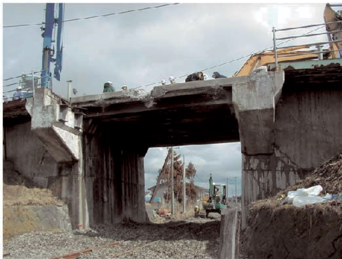
壊れた入江跨線橋（虻田町）
