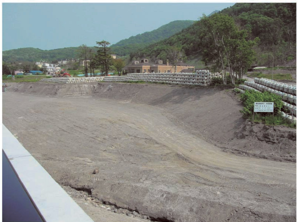
2000年噴火後に建設されている遊砂地
