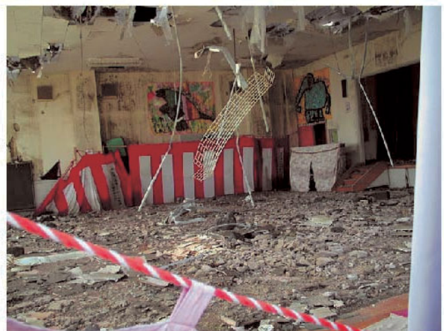
2000年噴火の際に、噴石で突き破られた幼稚園の天井
